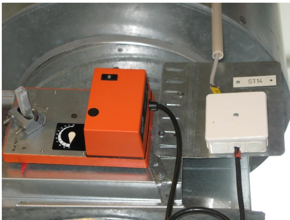
Figur 42: Ett ställdon i skolans ventilationssystem orsakade störningar.
