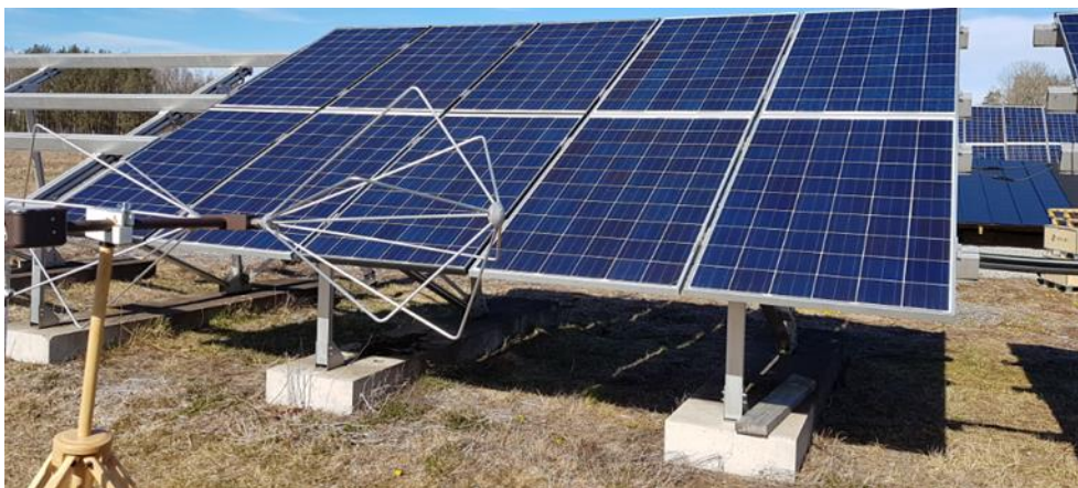
Figur 30: Solcellsanläggning med mycket hög störnivå.
