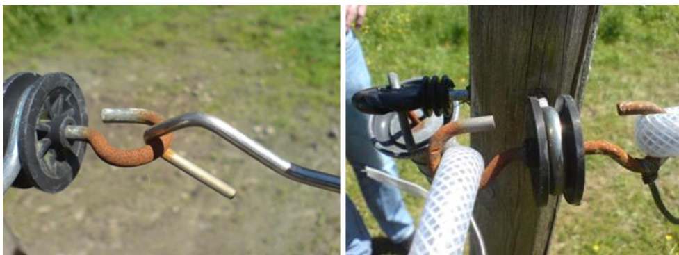
Figur 39: Dålig kontakt på grund av rostiga kontaktytor.
