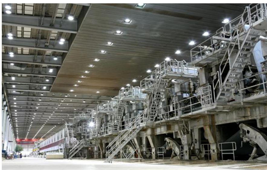
Figur 2: Ett exempel på hur en fast installation kan se ut.
